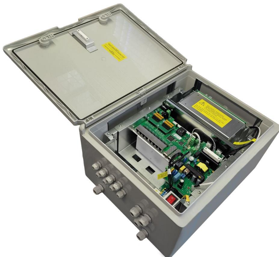
Рисунок 3.1.2 - PSW-2G8F+UPS-Box - вид внутри
