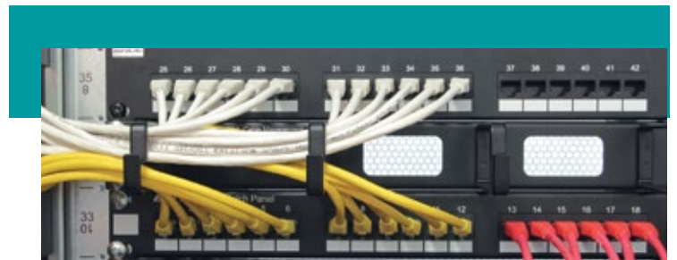
ГОРИЗОНТАЛЬНЫЕ ОРГАНИЗАТОРЫ ОБЕСПЕЧИВАЮТ ОТВОД КАБЕЛЕЙ К ВЕРТИКАЛЬНЫМ ОРГАНИЗАТОРАМ
